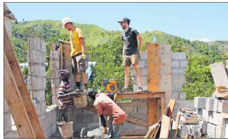
Schulbau vor dem Hurrikan: Johannes Klein (mit Bauhelm) mit weiteren Helfern auf der Baustelle in Beaumont.
